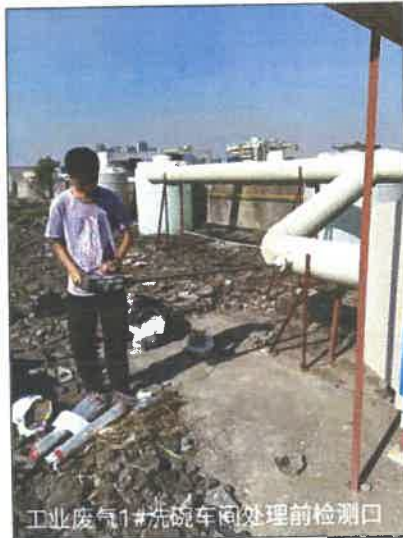
工业废气1#洗碗车间废气处理前检测口
