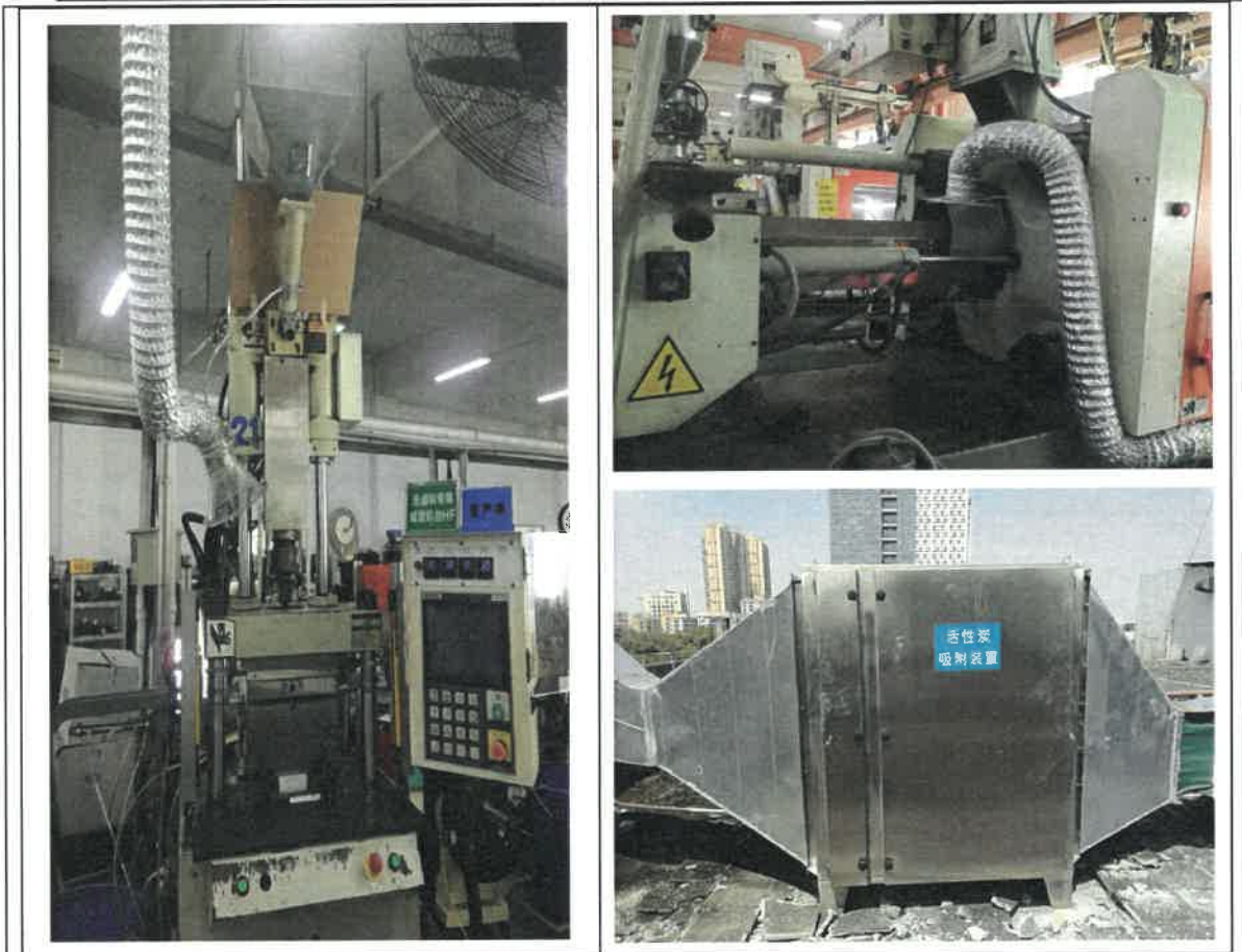
图 3-2 废气处理设施和收集措施
