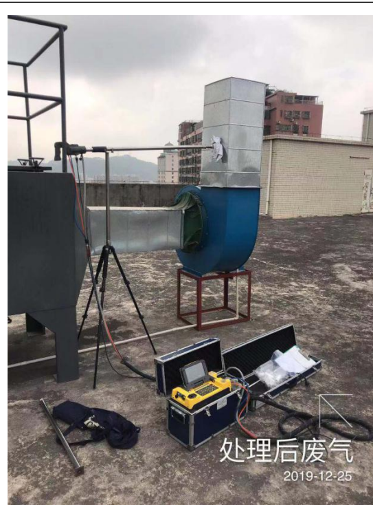
工业废气处理后检测口
