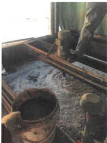
工业废水处理前取样口（原水）
