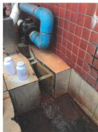
工业废水处理后排出口
