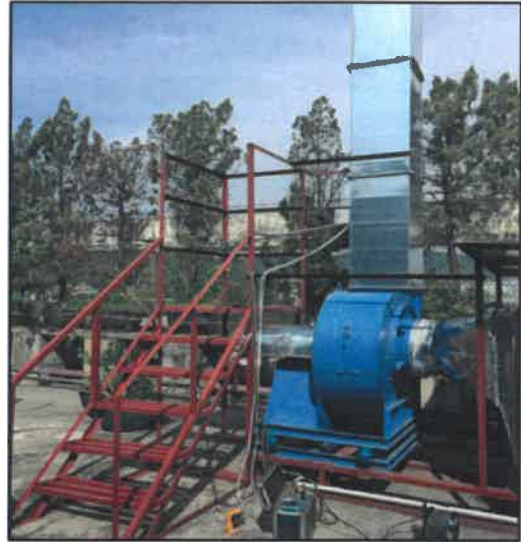
图2 喷漆废气处理塔处理后采样
