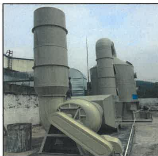
图 4 有机废气处理装置
