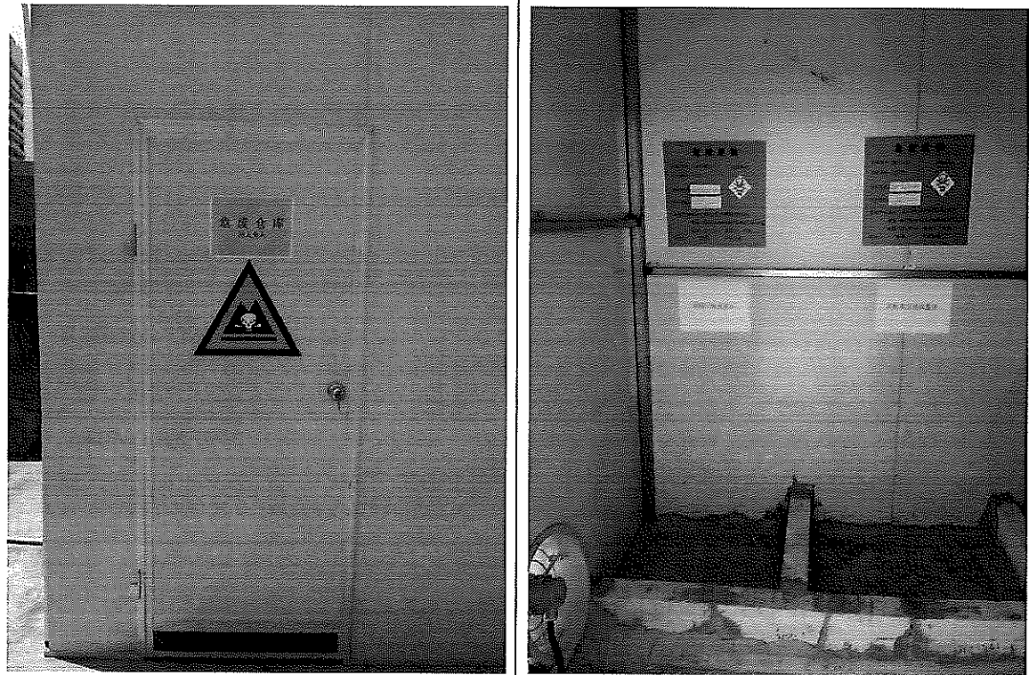
危险废物暂存间
