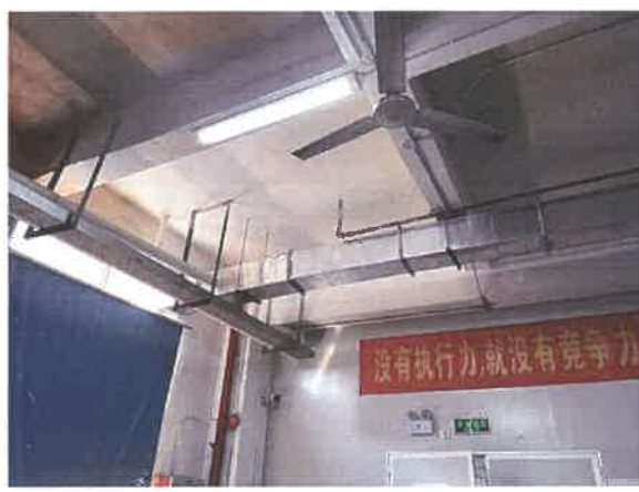
三楼生产车间收集管道
