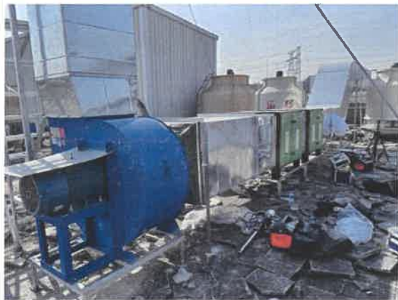
废气处理装置
