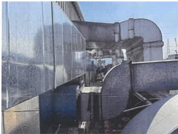
废气收集管道
