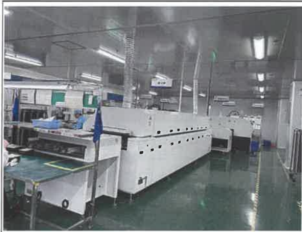
三楼生产车间收集管道
