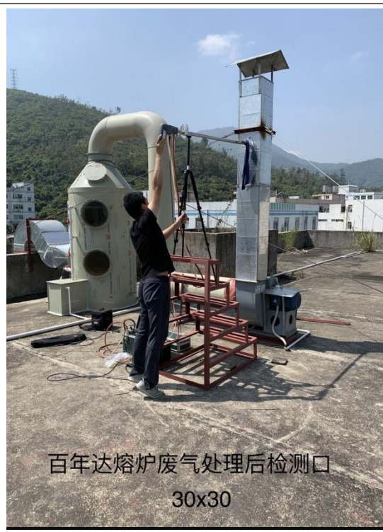
废气处理后检测口
