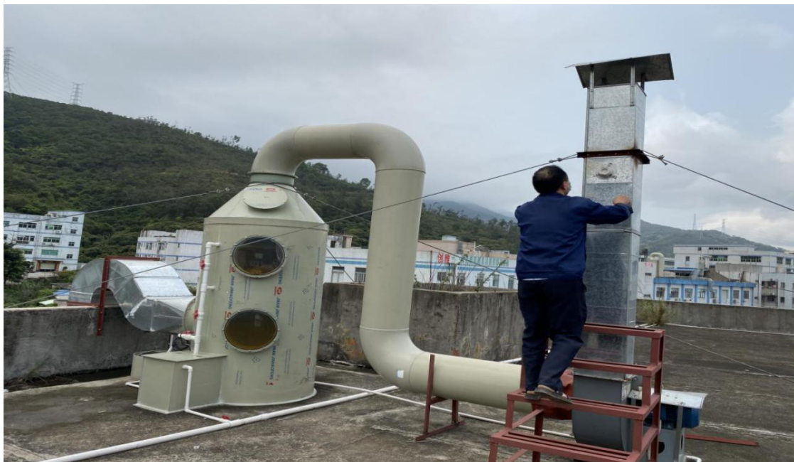
图 3-2 废气处理设备
